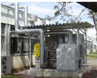
図3 実機スケール VOC 処理実験装置
